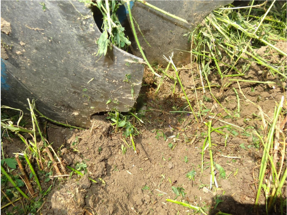
Abb.11: Keine ganzflächige Bearbeitung – bei der ersten Bearbeitung auch nicht notwendig! Schmale Stege zwischen den Bearbeitungsrillen
