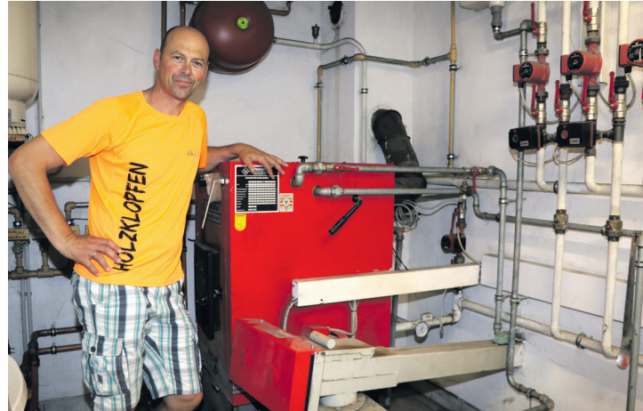
Die Anzahl der neu errichteten Hackgutheizungen blieb mit 2.245 Stück nahezu gleich. Foto: Paula Pöchlauser-Kozel/LK NÖ
